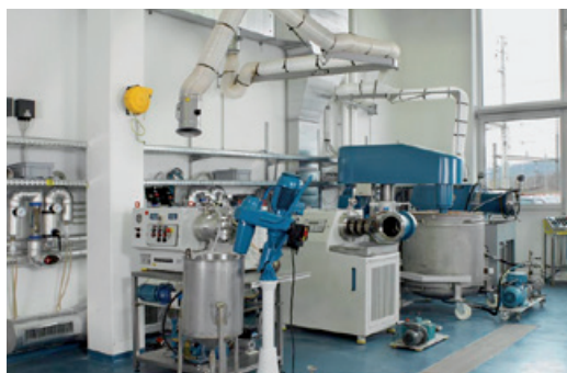
Centre technique équipé des broyeurs DYNO®-Mill dernière génération
