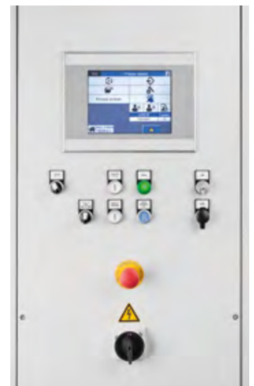
Coffret de pilotage
