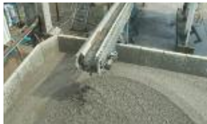
Évacuation des solides après traitement par un Décanteur Flottweg
