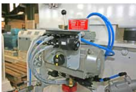
Répartiteur de raccordement rapide à la supervision
